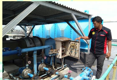
Gambar 1.2 Kerusakan pada Pompa Booster
