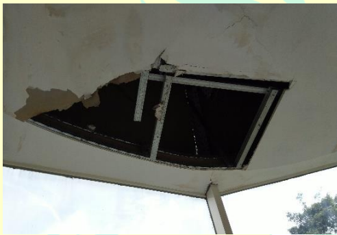
Gambar 1.1 Kerusakan pada Plafond
