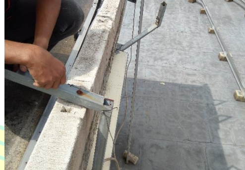
Gambar 1.6 Kerusakan pada Aluminium Composite Panel (ACP)
