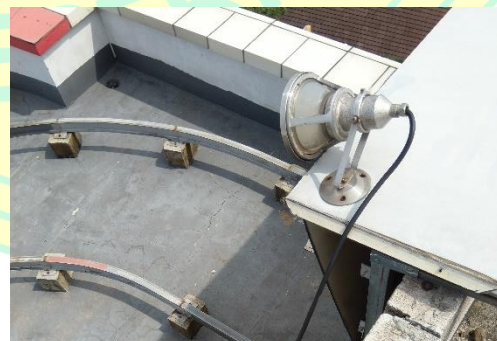
Gambar 1.4 Kerusakan pada Lampu
