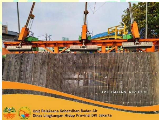
Gambar 4.2 Saringan Sampah Robotik di Stasiun Pompa Sungai Item (UPK Dinas Lingkungan Hidup Provinsi DKI Jakarta, 2021)
