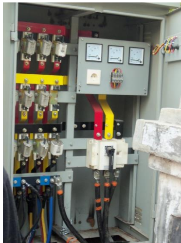
Gambar 2.17 Papan Hubung Bagi Tegangan Rendah (PHB-TR) Sumber: PT. PLN (Persero)
