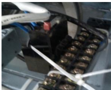
Gambar 3.49. Penyambungan dari regulator ke over switch .
