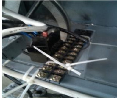
Gambar 3.50. Penyambungan dari over switch ke motor listrik.
