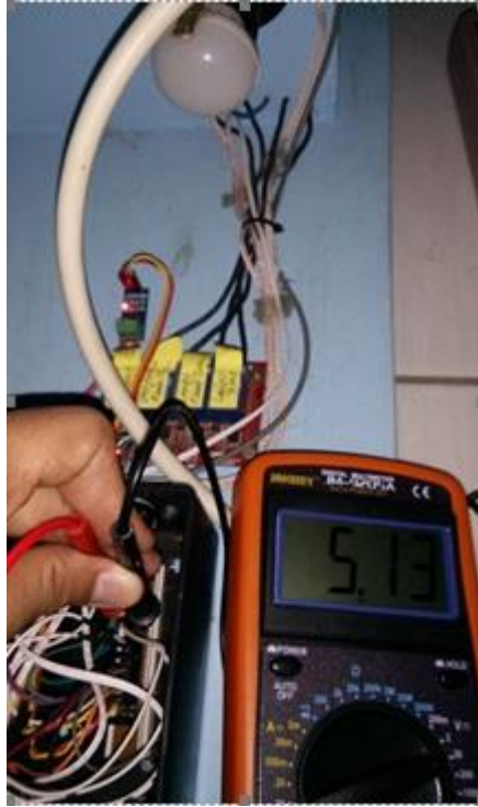
Gambar 4.7. Pengukuran Tegangan Sumber Power Supply
