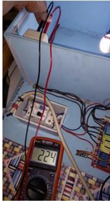
Gambar 4.2. Pengukuran Tegangan Stop Kontak
