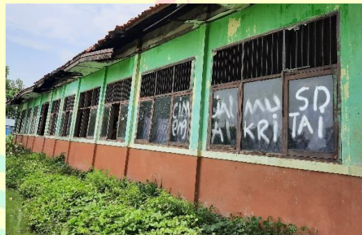
Gambar 1.3 Kerusakan pada Jendela SDN Samudrajaya 04 Bekasi (Dokumen Pribadi, 2020)
