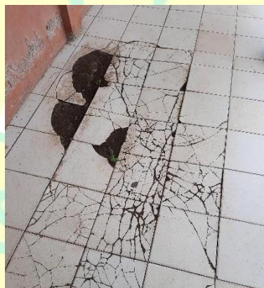
Gambar 1.1 Kerusakan pada Penutup Lantai SDN Samudrajaya 04 Bekasi (Dokumen Pribadi, 2020)
