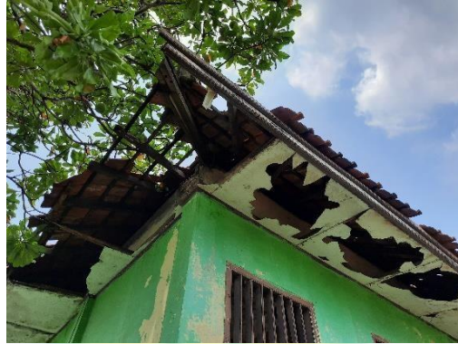
Gambar 1.2 Kerusakan pada Penutup Plafon SDN Samudrajaya 04 Bekasi (Dokumen Pribadi, 2020)
