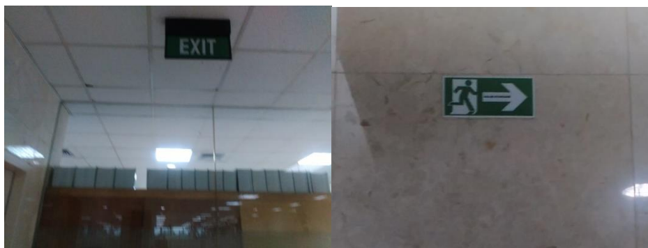
Gambar 4.16 tanda/petunjuk arah exit Gedung M.Syafei
