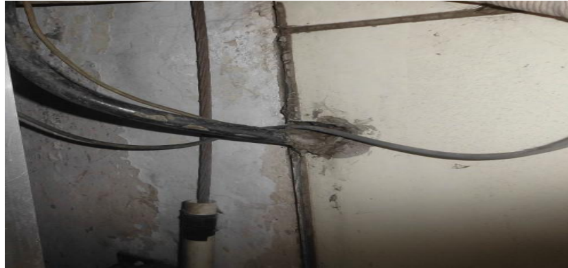
Gambar 4.14. Terminal Pentanahan Penangkal Petir Gedung Rektorat
