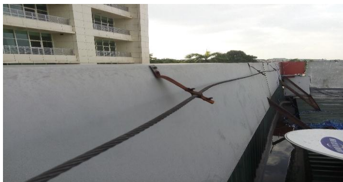
Gambar 4.11. Kabel Penghantar Sistem Instalasi Penangkal Petir Gedung Rektorat
