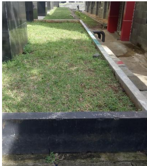
Gambar 4.23. Bak Gounding Penangkal Petir Gedung Raden Dewi Sartika yang Tertutup Tanah
