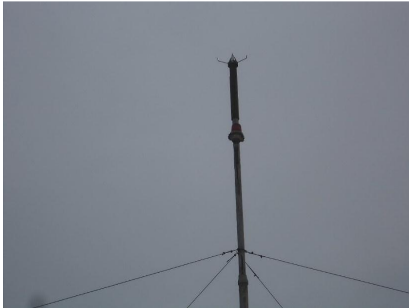
Gambar 4.15. Terminasi Udara Penangkal Petir Gedung Raden Adjeng Kartini
