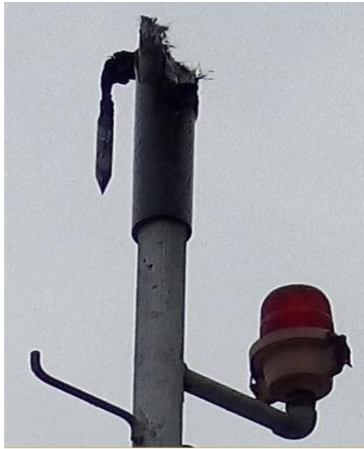
Gambar 4.20. Terminasi Udara Penangkal Petir Gedung Raden Dewi Sartika
