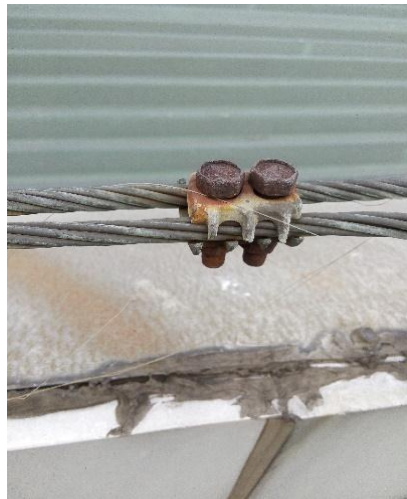
Gambar 4.12. Kuku Macan Kabel Konduktor Penangkal Petir Gedung Rektorat
