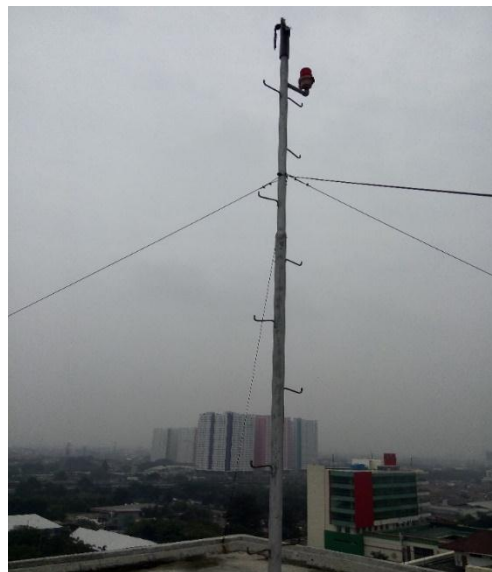
Gambar 4.21. Tiang Penyangga Penangkal Petir Gedung Raden Dewi Sartika
