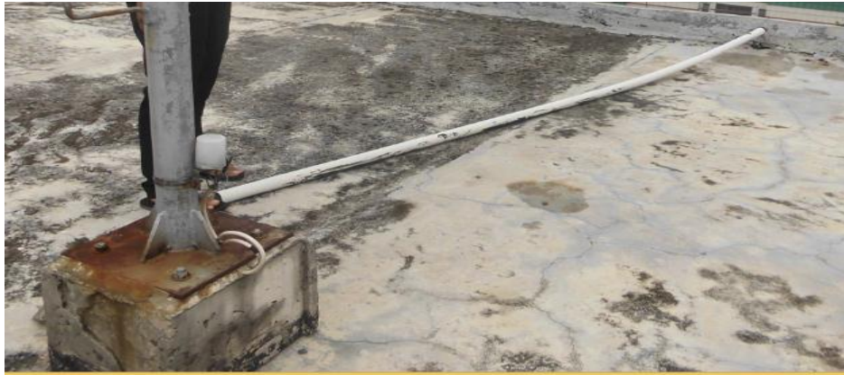
Gambar 4.17. Kabel penghantar Penangkal Petir Gedung Raden Adjeng Kartini
