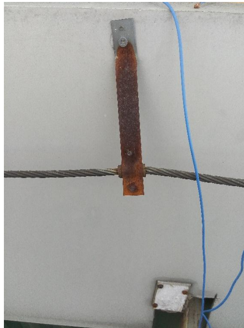
Gambar 4.13. Klem Kabel Konduktor Penangkal Petir Gedung Rektorat
