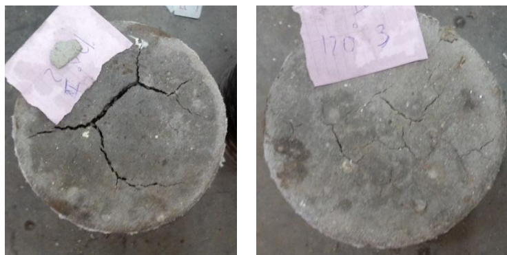
Gambar Retakan beton geopolimer setelah proses curing dengan temperatur 120°C
