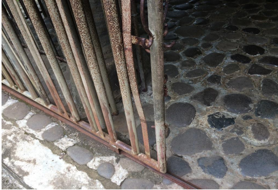
(Kondisi pagar yang ada di cungkup prasasti ciarueun yang berkarat)
