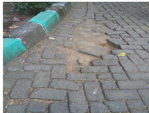
Gambar 22. Kondisi jogging track yang rusak
