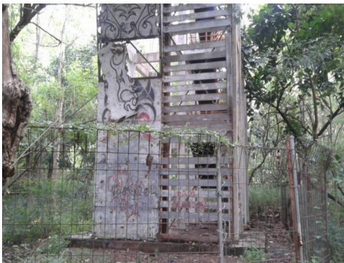
Gambar 23. Kondisi Wall Climbing yang rusak
