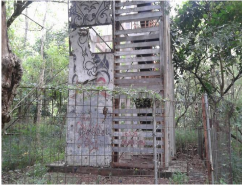
Gambar 23. Kondisi Wall Climbing yang rusak
