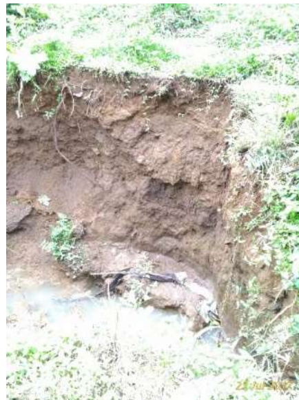
Gambar 8.. Salah satu titik tanah yang amblas tidak jauh dari permukiman
