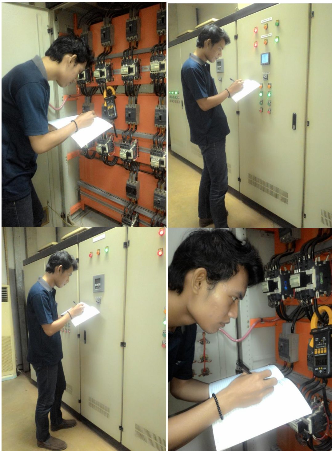
Gambar : Pengukuran Manual pada Panel Capasitor Bank
