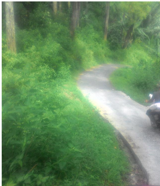
Gambar 7. Kondisi Jalan Kec. Sukaresmi
