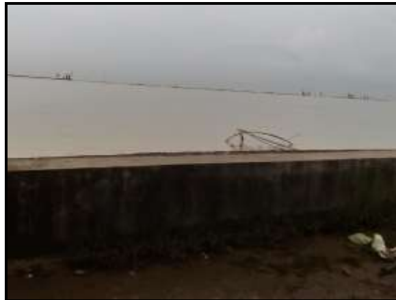
Gambar 3.6 Tanggul di sisi pantai guna menghalangi arus air laut masuk ke daratan.
