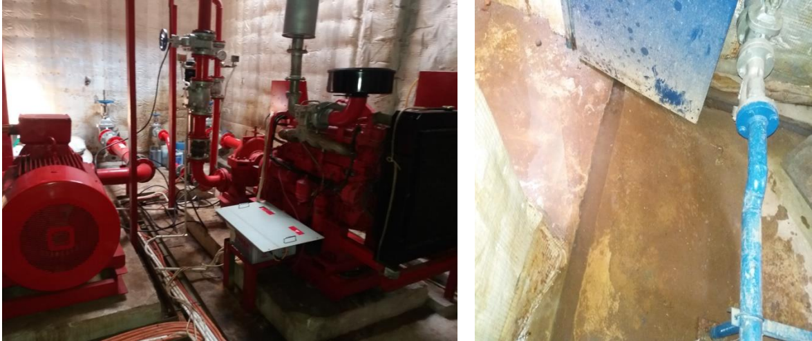
4.7 Gambar Ruang Pompa Sumber : Data Penulis
