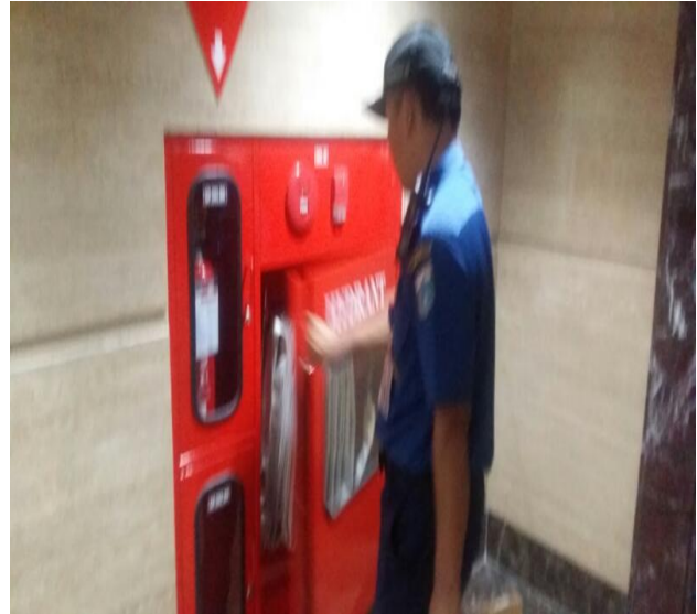
4.9 Gambar Hidran Gedung Sumber : Data Penulis
