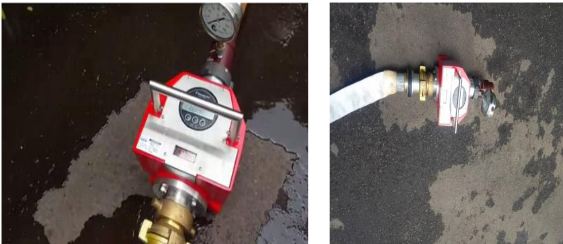
4.12 Gambar Flow Meter Sumber : Data Penulis
