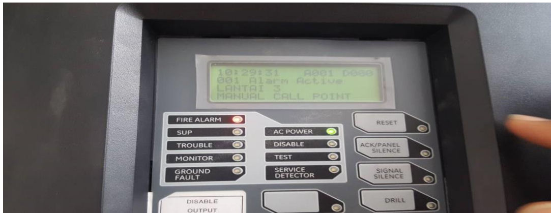
4.5 Gambar MCFA/ Kontrol Panel Alarm Sumber : Data Penulis
