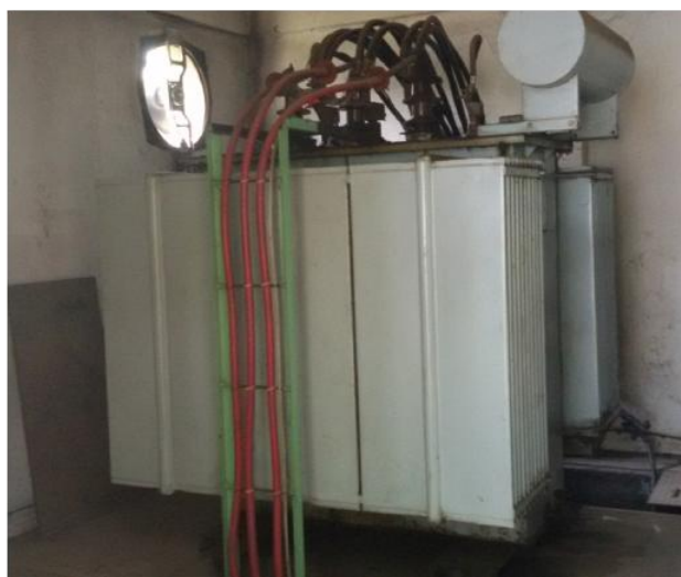
Trafo 2 Patal I
