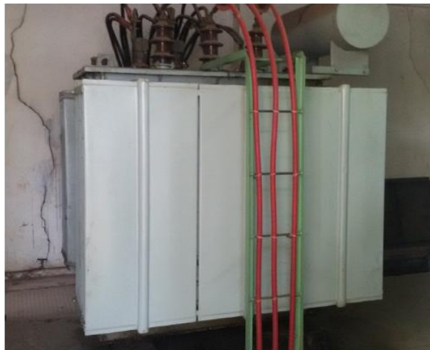
Trafo 1 Patal I
