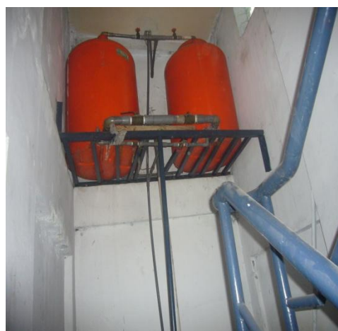
Gambar 4.34 Penampungan air di Tangga Darurat
