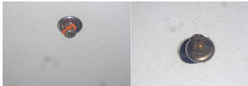
Gambar 4.14 Sprinkler Tersegel Dan Sprinkler Rusak
