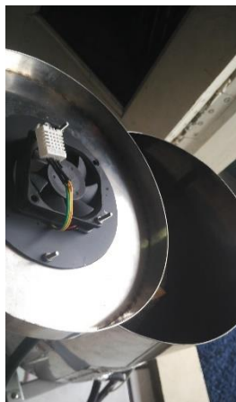
Lampiran 8 : Fan dan DHT22 Terletak di Bagian Atas atau Penutup Pengering
