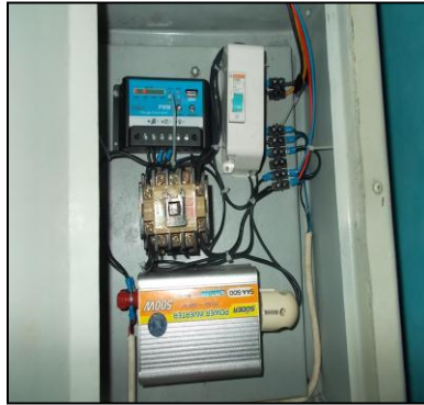
Gambar 4.7 Penempatan sistem kontrol kedalam box Sumber : Dokumentasi (2015)
