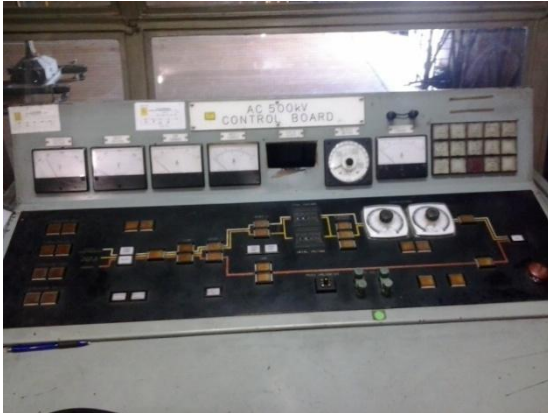
Gambar 2.1 Tegangan Tinggi AC volatge
