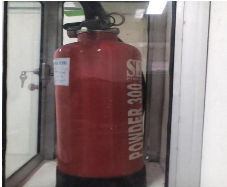
Gambar 4.1 APAR di Laboratorium
