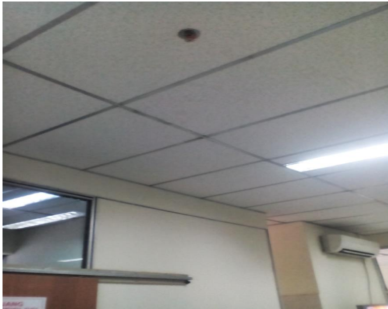
Gambar 4.6 Sprinkler di Laboratorium
