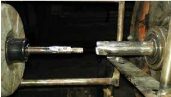
Gambar 4.8. Generator dan Turbin Saat Terlepas
