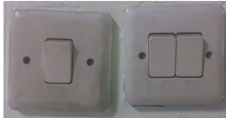
Gambar 2.7 Saklar (Sistem Kendali Manual Lampu)
