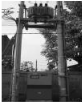
Gambar 2.10 Gardu Portal Sumber : Buku 4 PT. PLN (Persero)
