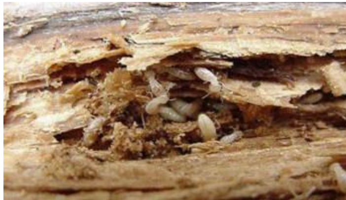
Gambar 2.7. Bambu Rusak Akibat Serangan Rayap Tanah
