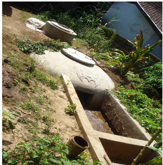
Foto 8. Instalasi digester biogas yang terdiri dari inlet, digester, outlet, dan bak penampung sludge. Sludge merupakan hasil sampingan biodigester berupa lumpur yang dapat diolah menjadi pupuk cair dan padat organik
