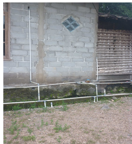
Foto 4. Instalasi pipa gas penyalur biogas dari biodigester menuju ke rumah pengguna biogas
