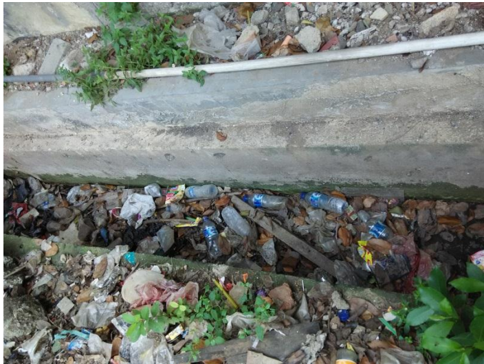
Gambar 1.2 Sampah yang menutupi selokan di area Kantin UNJ
