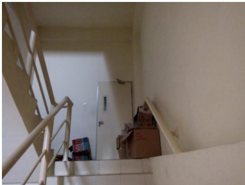
Gmabar 4.69 Pintu Darurat yang Terhalang Barang
