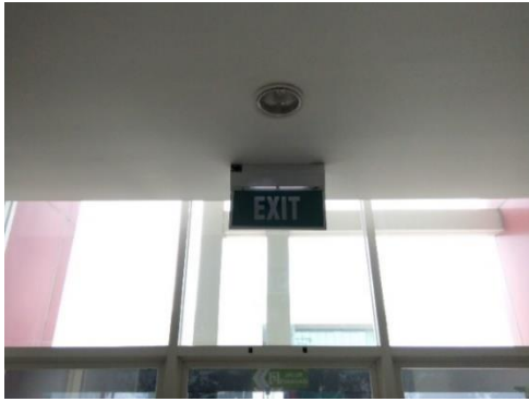
Gambar 4.38 Tanda “EXIT” didepan Pintu Darurat
