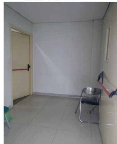
Gambar 4.7 Kondisi Pintu Darurat yang Digunakan penghuni sebagai akses keluar setiap hari
