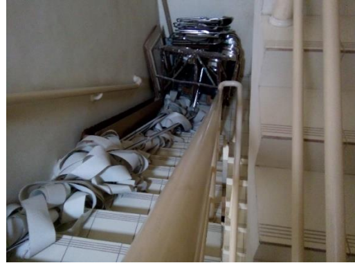
Gambar 4.68 Tangga Darurat Arah Selatan yang Terhalang Barang
