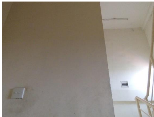
Gambar 4.64 Penerangan Darurat Akses Tangga Darurat
