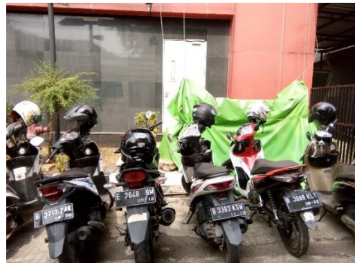
Gambar 4.70 Pintu Darurat yang terhalang Gondola dan Kendaraan
