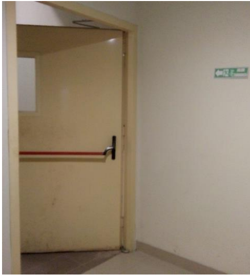
Gambar 4.18 Tanda Exit Menuju Tangga Darurat Arah Timur
