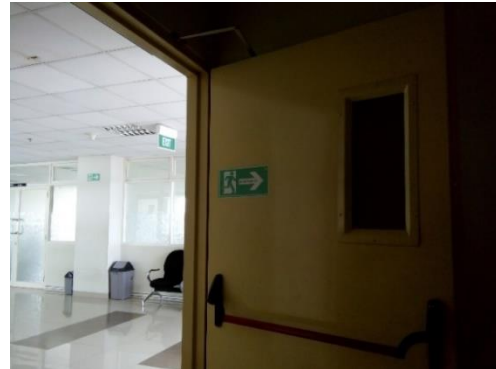
Gambar 4.39 Tanda Petunjuk Jalur Evakuasi di Pintu Darurat
