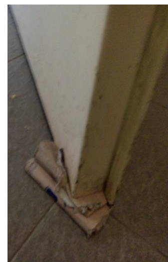
Gambar 4.32 Pintu Darurat yang Ditahan
