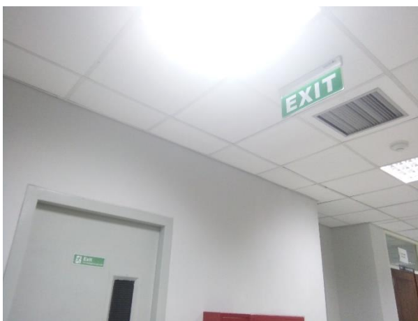
Gambar 4.54 Tanda “EXIT” didepan Pintu Darurat
