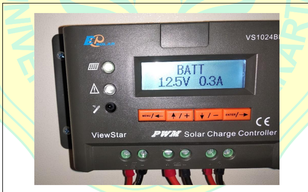
Solar Charge Controller Pengambilan Data Arus dan Tegangan Baterai
