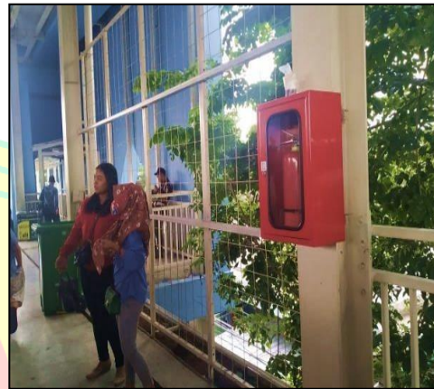
Foto 6. Fasilitas APAR di Jembatan Penyeberangan Multiguna Tanah Abang Sumber: Oleh Peneliti, 2019.
