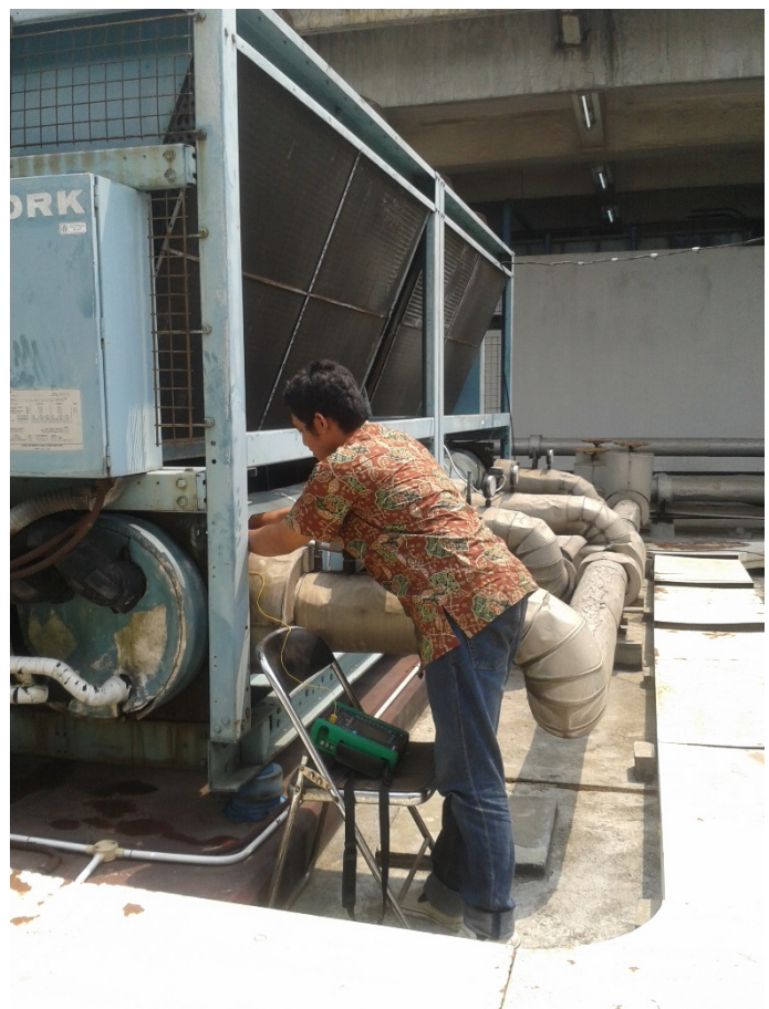
Peneliti sedang meletakkan Sensor Termokopel ke dalam Chiller (tampak dari Kejauhan)
