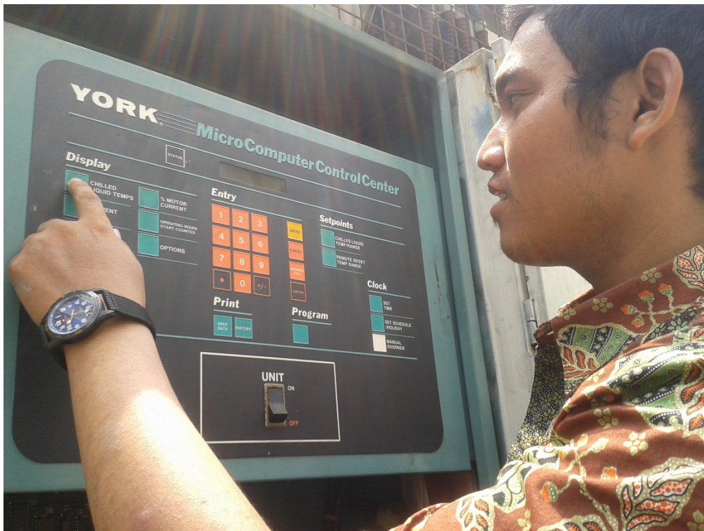
Peneliti sedang mengamati display monitor chiller
