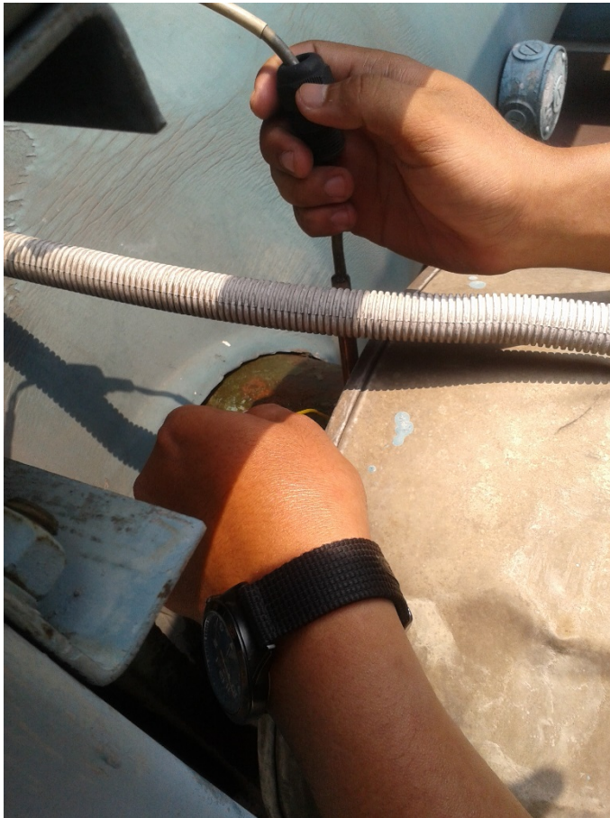
Peneliti sedang meletakkan Sensor Termokopel ke dalam Chiller
