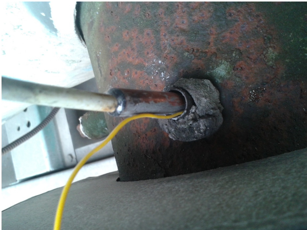
Sensor Termistor dan Termokopel dimasukkan bersamaan ke dalam Chiller
