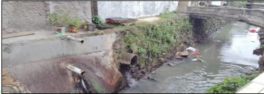
Gambar 1. 2Pipa-Pipa Pembuangan di Kali Pasar Ciracas
