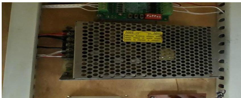
Gambar 2.15 Power Supply Sumber: Dokumentasi Pribadi 2018
