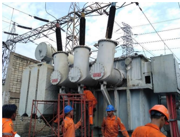
Gambar 2.1 Transformator Tenaga (Sumber: Dokumen Pribadi)
