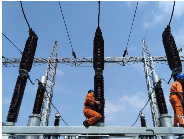
Gambar 2.4 Pemutus Tenaga (PMT) (Sumber: Dokumen Pribadi)
