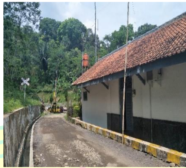
Kondisi Jalan di depan Stasiun Lampegan
