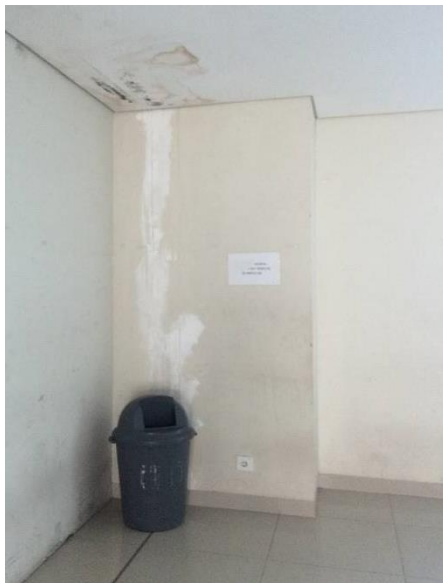
Gambar 4.7 Plafond dan kolom yang terlihat kotor
