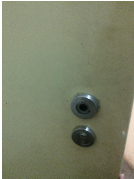
Gambar 4.5 Grendel pintu darurat yang hilang
