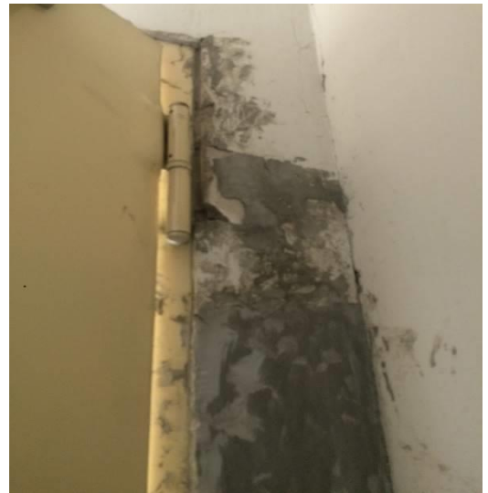
Gambar 4.4 Tambalan pada dinding yang tidak rapih
