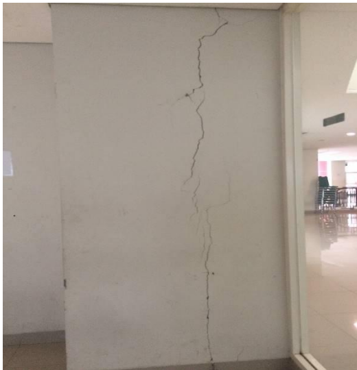
Gambar 4.3 Keretakan pada struktur kolom
