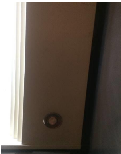
Gambar 4.15 Lampu lift yang mati
