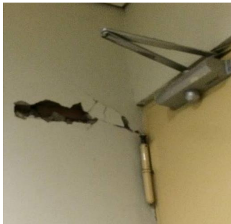
Gambar 1.3 Kerusakan dinding pada bangunan gedung Raden Dewi Sartika
