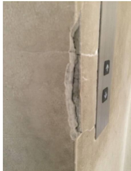
Gambar 4.6 Rusaknya dinding disekitar lift
