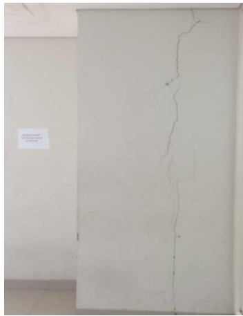
Gambar 1.1 Retak rambut pada kolom bangunan gedung Raden Dewi Sartika
