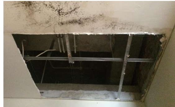
Gambar 1.2 Kerusakan pada plafon bangunan Gedung Raden Dewi Sartika
