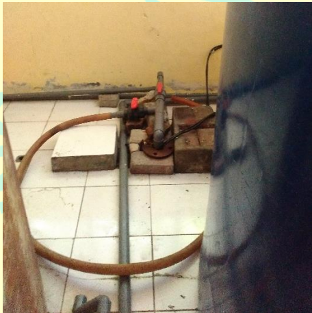
Sumur sumber air RO ( Reverse Osmosis ) di Pulau Untung Jawa
