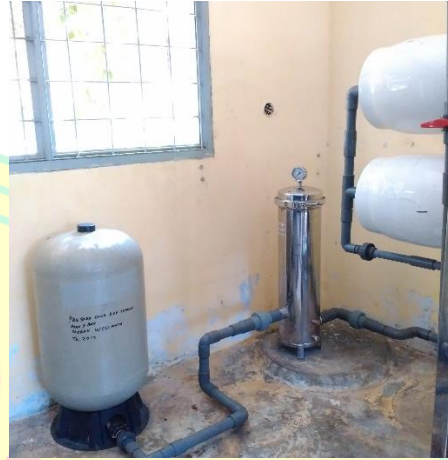
Mesin pengalir air RO ( Reverse Osmosis ) menuju tangki penyimpanan sementara
