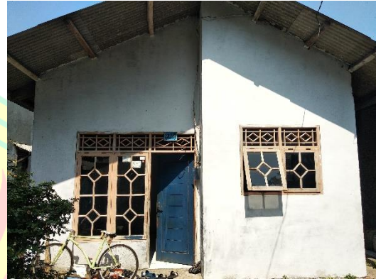
Atap Rumah berbahan asbes di Pulau Untung Jawa
