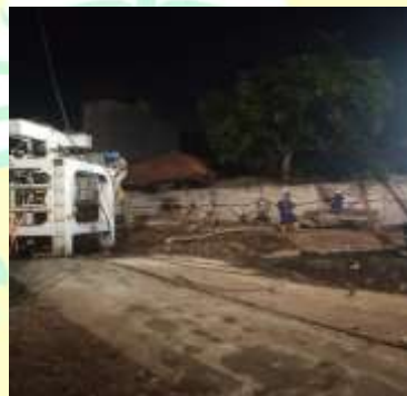
Gambar 1.3. Kecelakaan Kerja Bore Pile
