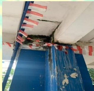
Gambar 1. 3 Kebocoran Atap Beton Pada Blok G Lantai 1
