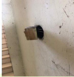
Gambar 1. 1 Saklar Copot Pada Koridor Blok G Lantai 2
