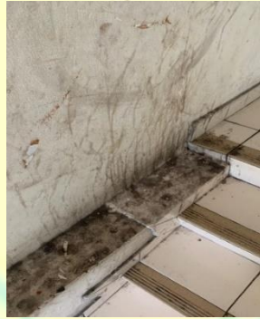
Gambar 1. 2 Lantai Kotor Pada Koridor Blok H Lantai 2
