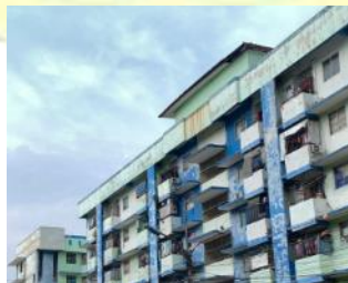
Gambar 1. 5 Rusaknya Cat Luar Blok H
