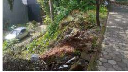
Titik kerusakan longsor (Desember 2023)
