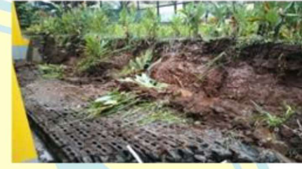
Titik kerusakan di tempat wudhu masjid (Oktober 2024)
