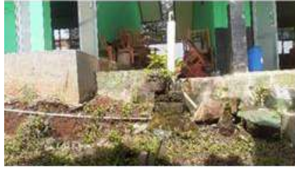
Titik kerusakan di depan ruang kelas (Februari 2023)
