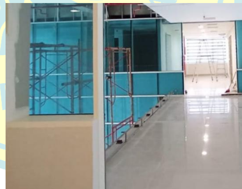
Gambar 1.6 Void area Jembatan Komunal Lantai 7 (Dokumentasi Pribadi, 2023)
