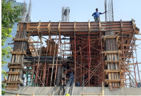
Gambar 1. 1 Tidak Menggunakan Alat Pelindung Diri
