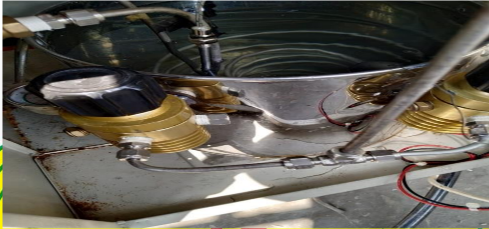
Gambar 3.5 Pengujian temperatur maksimal air pada heat exchanger
