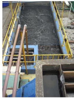
2.1 Pengolahan limbah cair domestik (Sewage Treatment Plant) pada bak ekualisasi
