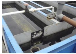
2.2 Pengolahan limbah cair domestik (Sewage Treatment Plant) pada clarifier
