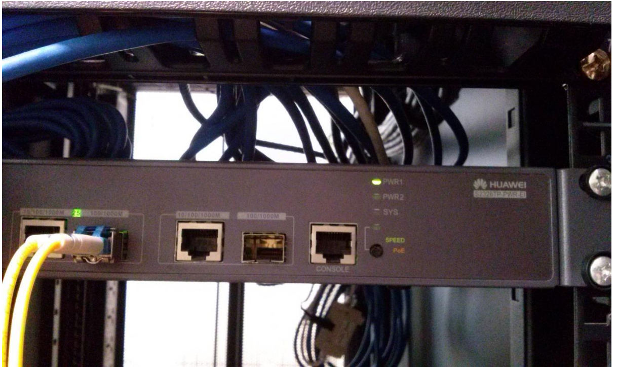
Switch Huawei 2326 Layer 3 lantai 1
