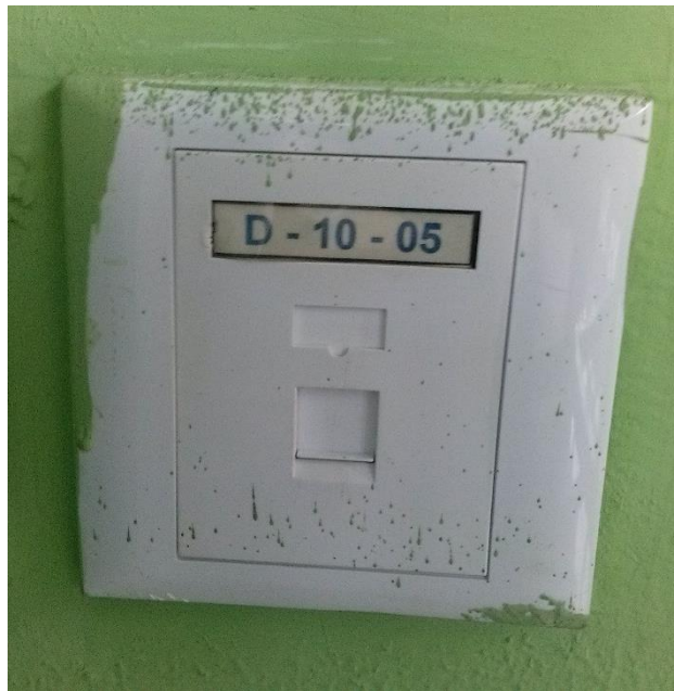
Faceplat RJ45 yang ada setiap ruangan
