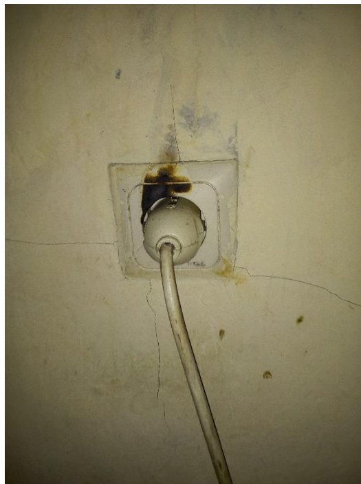
Foto Perlengkapan Instalasi Stop Kontak Tidak Layak
