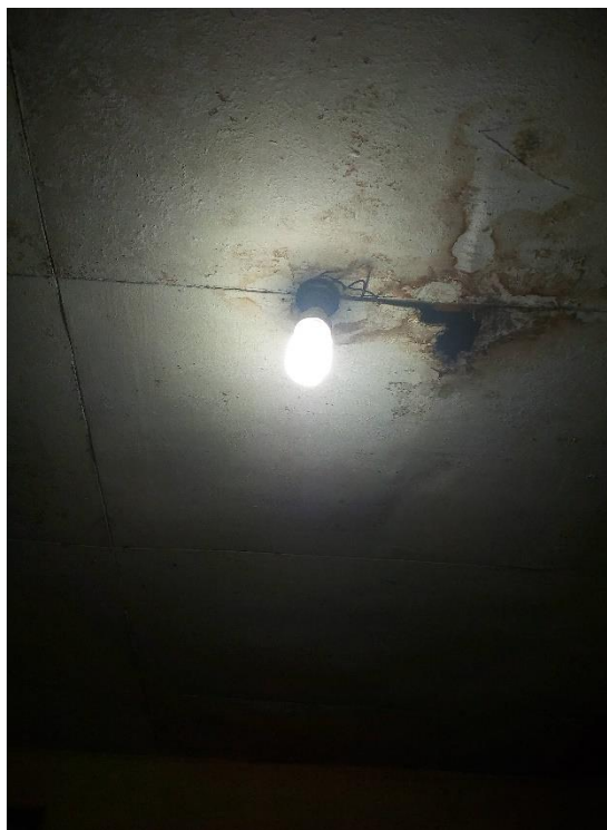
Kondisi plafon dan fitting lampu yang tidak layak
