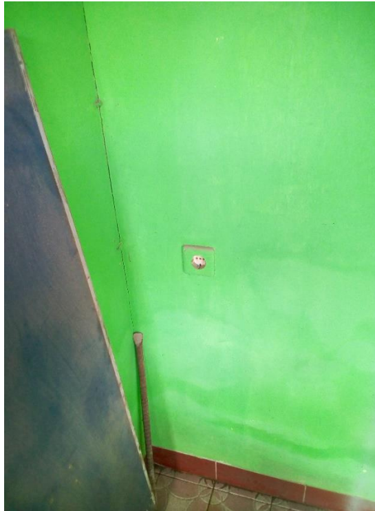
Pemakaian Stop Kontak Pasangan Luar Tanpa Penutup
