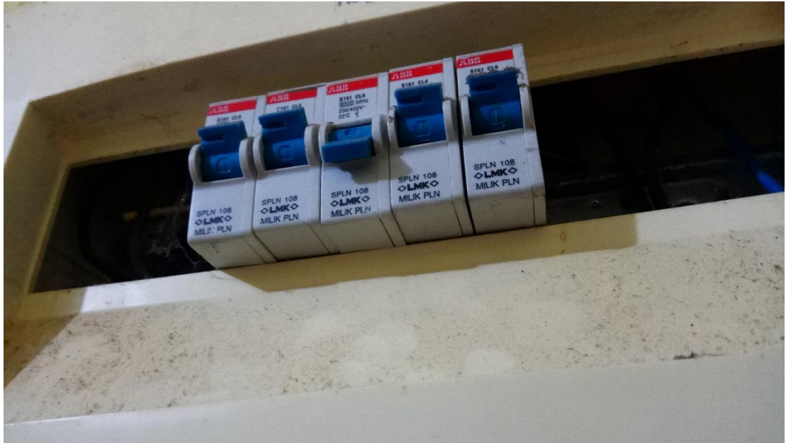
Pengecekan Pengaman Instalasi
