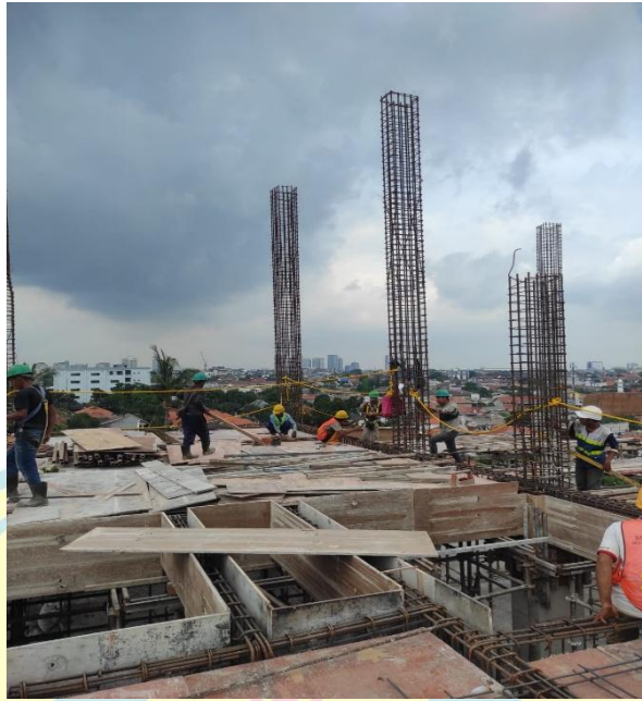
Gambar 1. 2 Kondisi area kerja bekisting dan perancah yang belum tertata secara optimal
