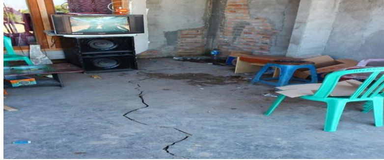
Gambar 7. Retakan pada lantai rumah
