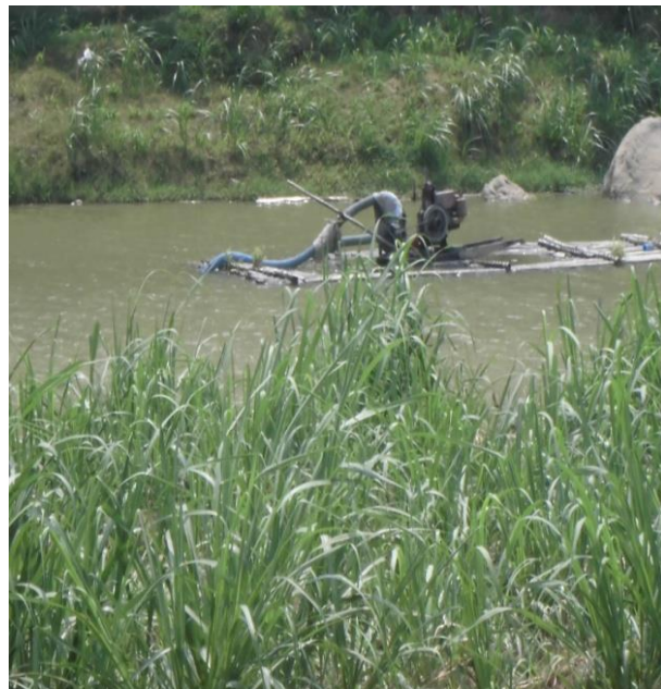
Proses pengambilan pasir dengan mesin sedot
