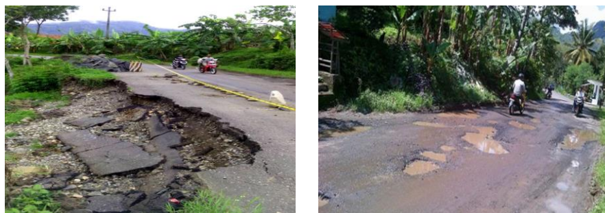
Gambar 3. Jalan yang longsor dan berlubang
