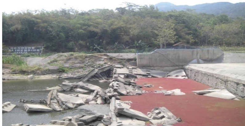
Gambar 5. Bendung Kaligending yang rusak
