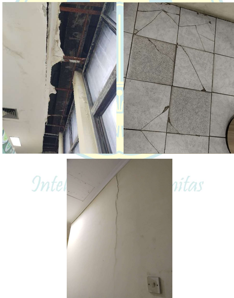
Gambar 1. 1 Kerusakan Gedung Perpustakaan
